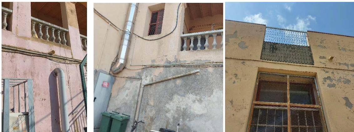
Elements instal·lació evacuació de les aigües
