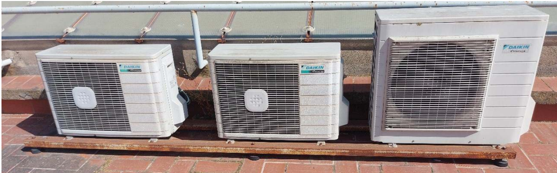
Equips de climatització actuals
