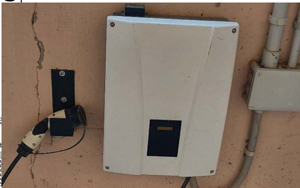
Punts de càrrega de vehicle elèctric
