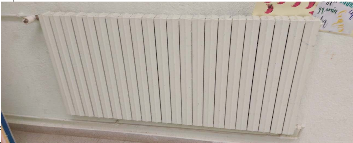
Sistema de calefacció
