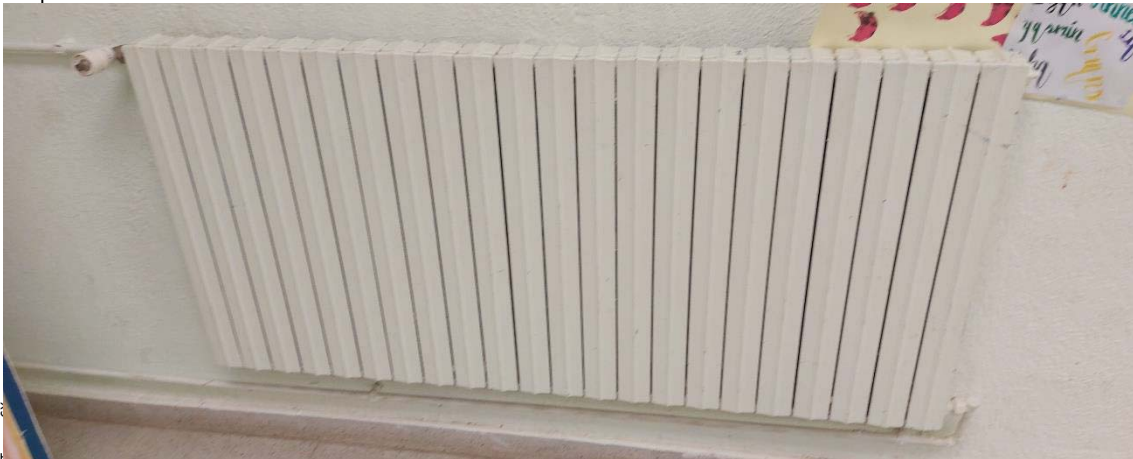
Sistema de calefacció
