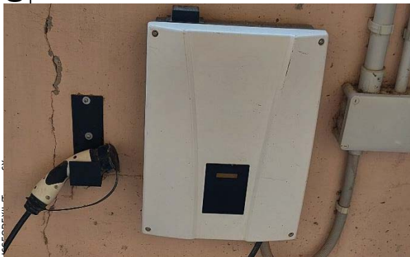
Punts de càrrega de vehicle elèctric
