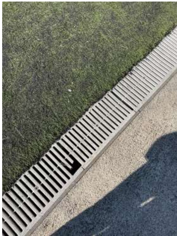
Detall reixa lateral d'evacuació a substituir.
