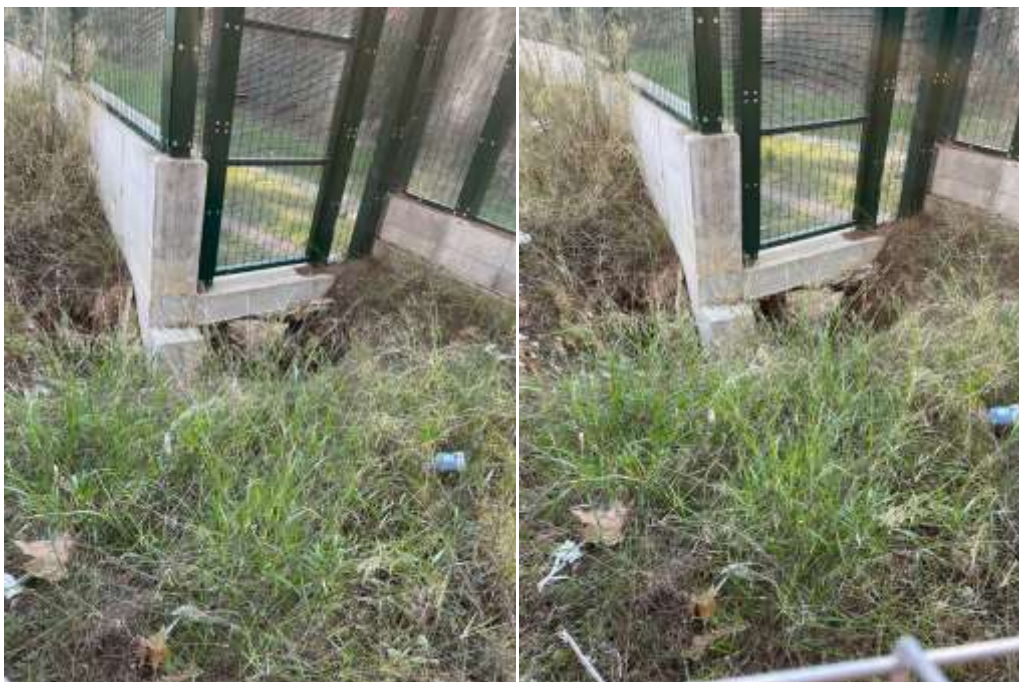
Zona lateral del camp de futbol que dona a la riera que es tancarà amb un mur d'escullera i es col·locarà una nova reixa d'evacuació d'aigües.
